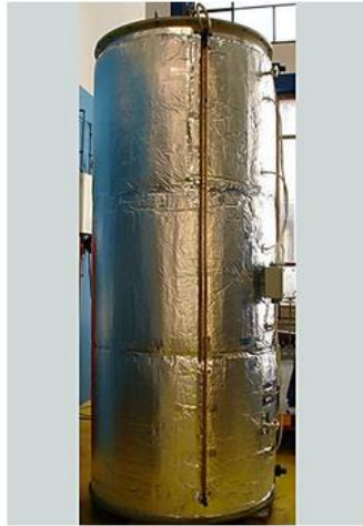
Kessel isoliert, betriebsbereit
